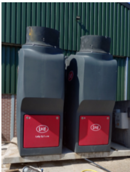
Afbeelding 3: Luchtwassersysteem (eigen beeldmateriaal).
